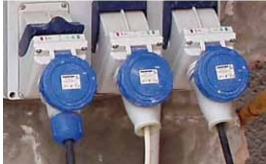
Figura 14 (izqda.) Conexión incorrecta
