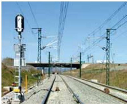
Figura 44 (izqda.) Detalle de una estación transformadora
